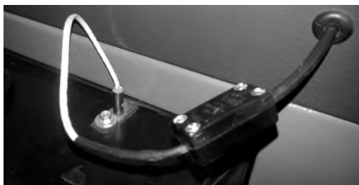
Rysunek 5 Czujnik temperatury spalin zamontowany w czopuchu
